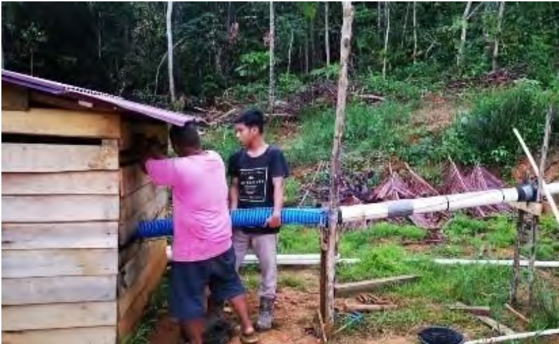
Gambar 17. Instalasi air bersih bersama masyarakat Sumber: Tim CSR ANTAM UBP Bauksit Kalimantan Barat
